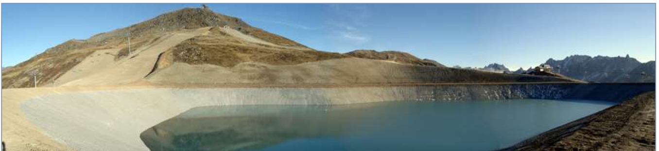
Retenue collinaire à Valloire, Savoie
